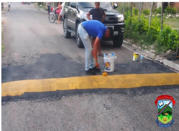
Señalización de reductor de velocidad, la piedra 2
